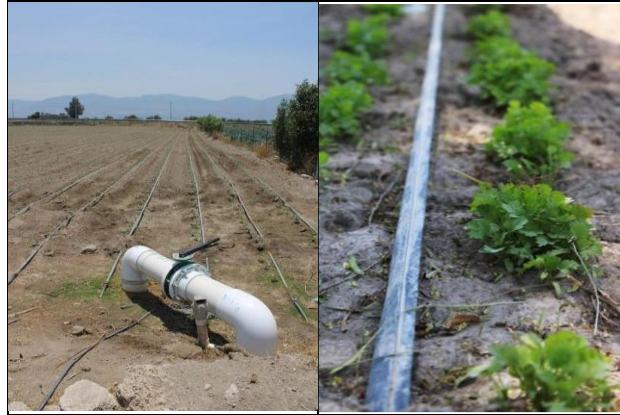
Figura 1. Bombeo de agua de pozo y sistema de riego por goteo en sistema de producción semi tecnificada.
